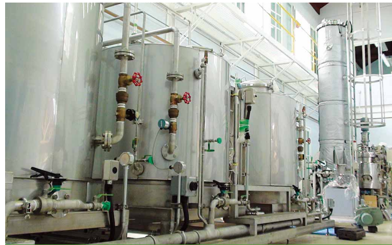
ペトロbras社に設置されたバイオ水素共同研究実証プラント(ブラジル)
