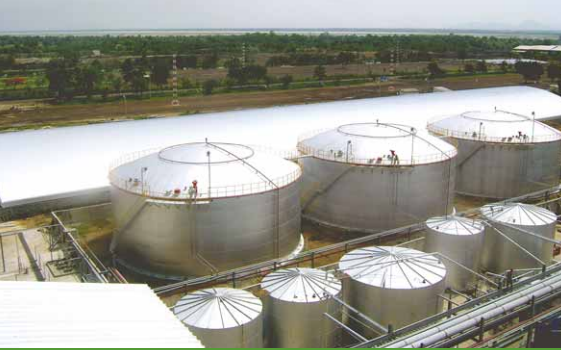
バイオエタノール貯蔵タンク(タイ)
