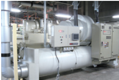
北海道工場に導入した高効率冷水ターボ冷凍機
