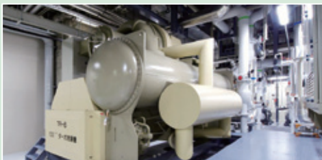
「恵比寿ガーデンプレイス」の地下5階に設備を集約、2011年はターボ冷凍機(1,000USRt×2基)を新設しました。
