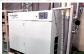
群馬工場の高効率コンプレッサー
