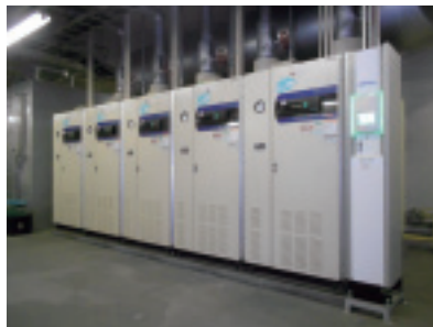
仙台工場のボイラ設備
