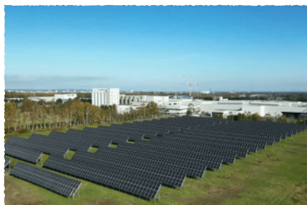
サッポロビール北海道工場の太陽光発電設備
