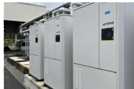
ノンフロン型ヒートポンプ給湯設備
